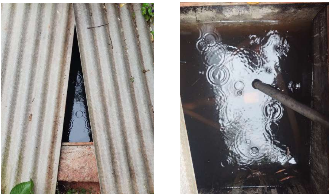
Figura 1. Nas figuras A e B, é possível perceber o alagamento do local onde a bomba está armazenada, o que ocasiona a inundação e a queima da bomba. Fonte: Autores, 2024.
